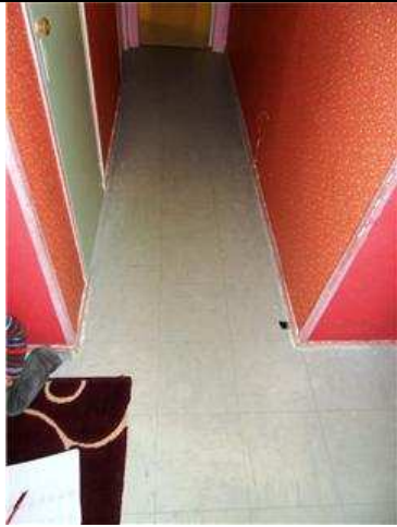
001 - Appartements - Entrée LOT 0001 PH23 : dalles supérieures non amiantées Posées sur dalles, colle et ragréage amianté PRE023
